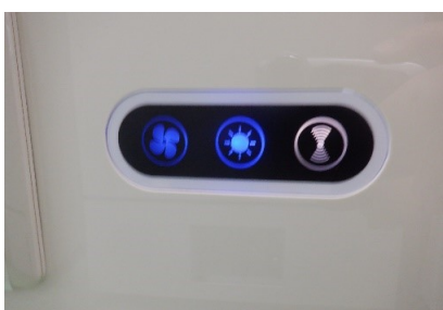
ファン、照明点灯
